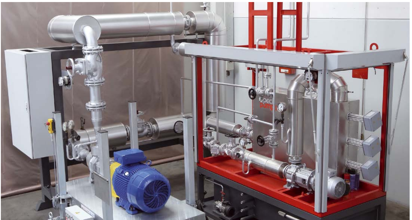
Thermalölprüfstand mit Pumpenüberwachungssystem im Werk von Speck in Roth.
